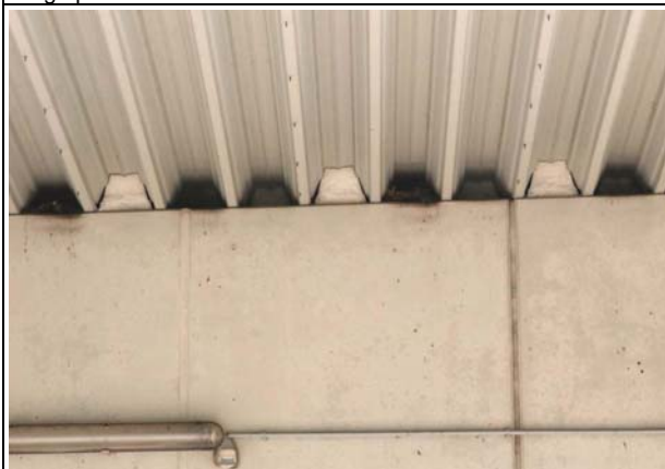
Brutkolonie des Haussperlings im Bereich von Nischen an der Dachkonstruktion
